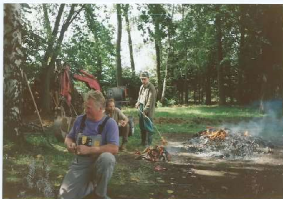
Poškozené vnější stěny chatky bylo nutno opravit. Při přestávce na občerstvení všem chutnalo...
